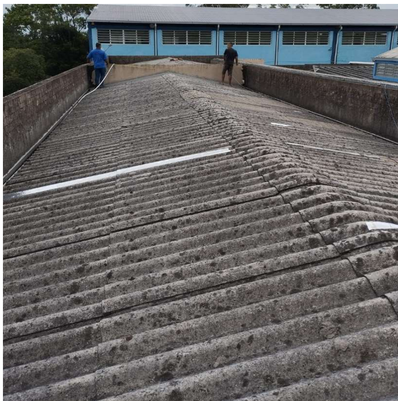
Imagem – Telhamento das Salas de Aula a ser substituído
