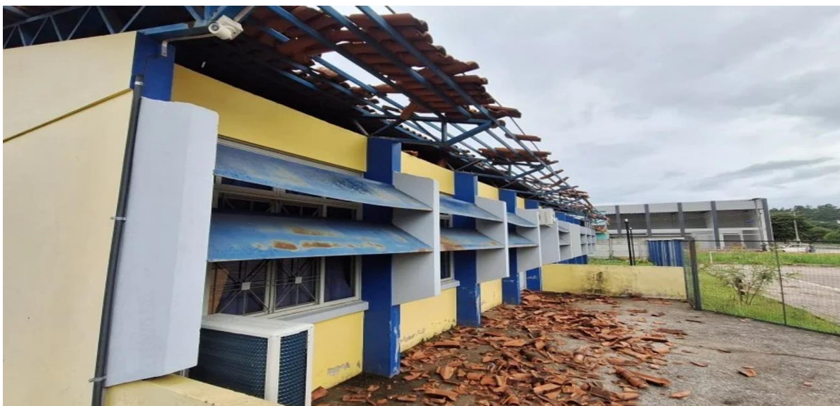
Figura 9. Destelhamento de prédios públicos ocasionados pelo vendaval de 2024
