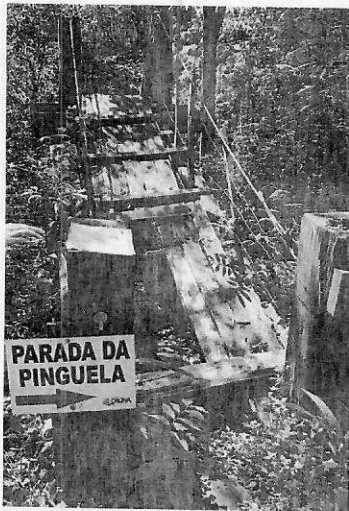
Figura 2 Rampa de acesso (danificada)
