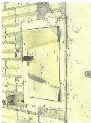
Figura 10 - Caixa de distribuição de energia
