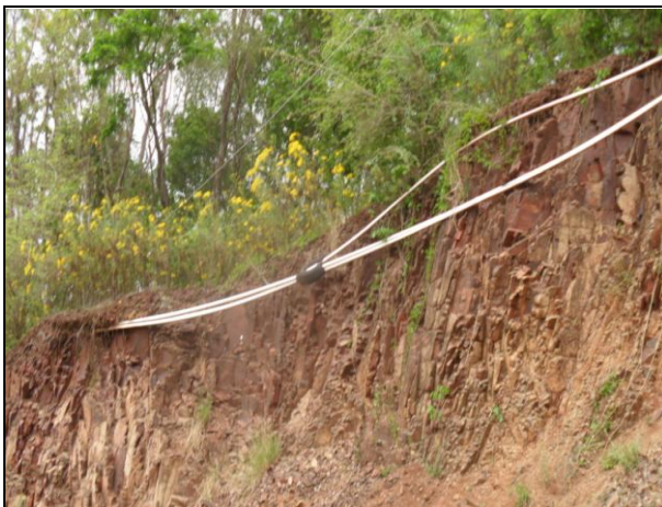
FOTO 03 – Rede de Distribuição
