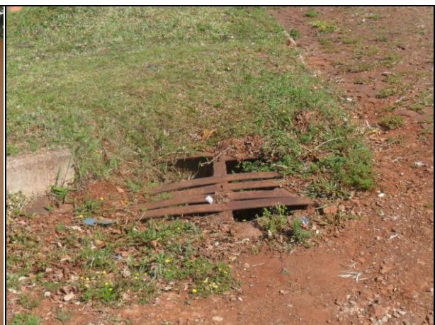
FOTO 04 – Boca de Lobo
