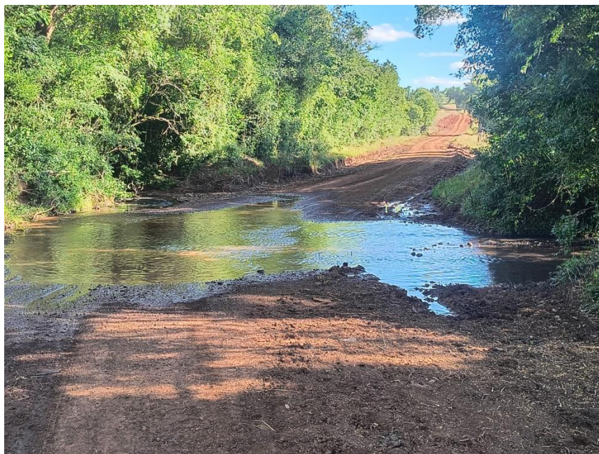
Figura 3 – Rincão dos Feijó, necessidade da execução de um bueiro
