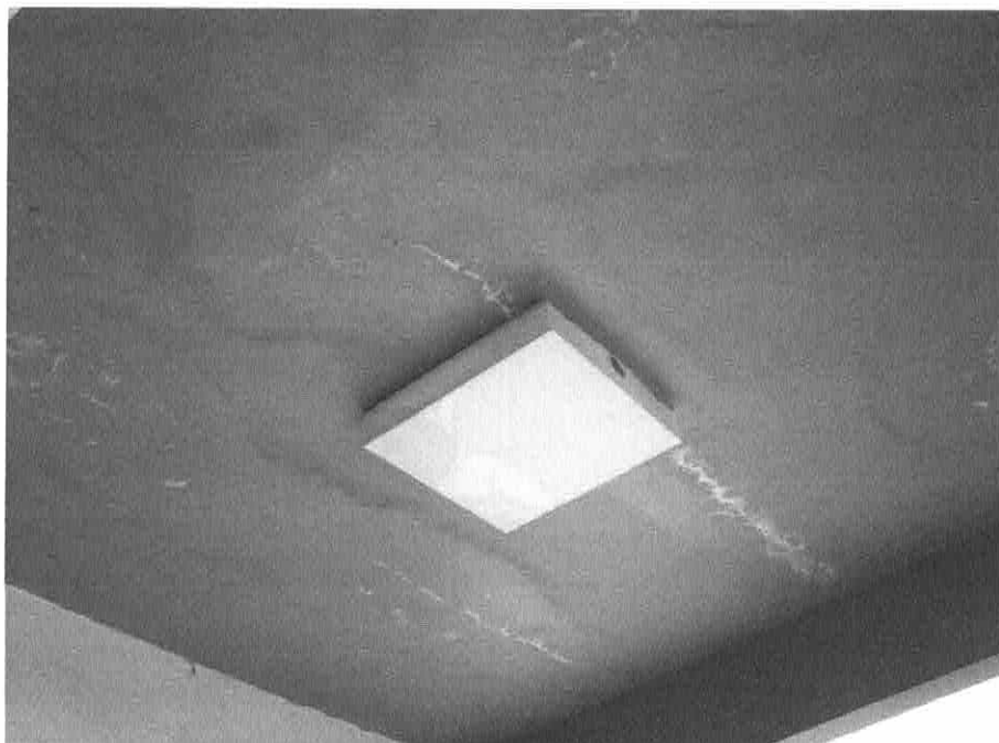
Figura 6 - Efflorescência na laje
