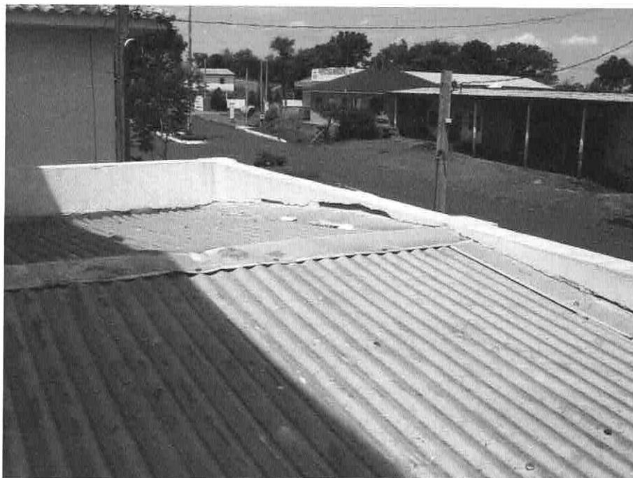
Figura 12 - Descolamento do revestimento próximo ao rufo metálico.
