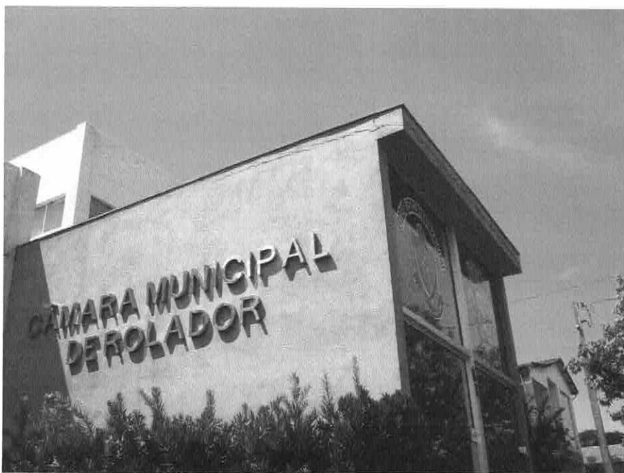
Figura 9 - Fissura na fachada principal, característica de movimentação da laje
