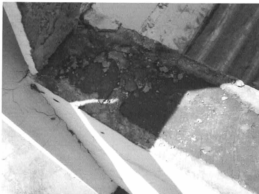
Figura 13 - Descolamento total do revestimento da platibanda e proliferação de insetos
