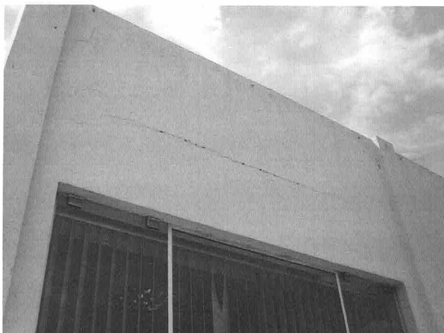
Figura 8 - Fissura característica de movimentação de laje de cobertura.
