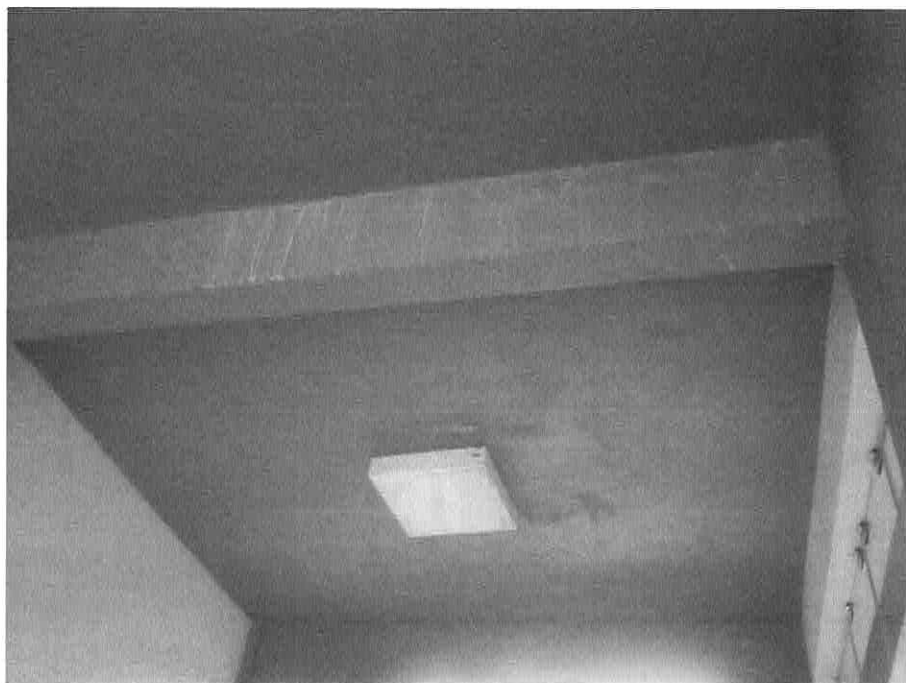
Figura 5 - Efflorescência na Viga
