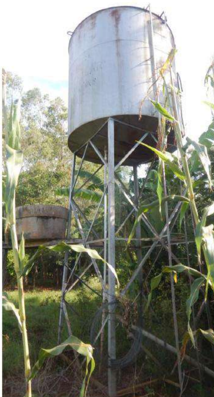
Figura 70. Reservatório de água lajeado Viamão.
