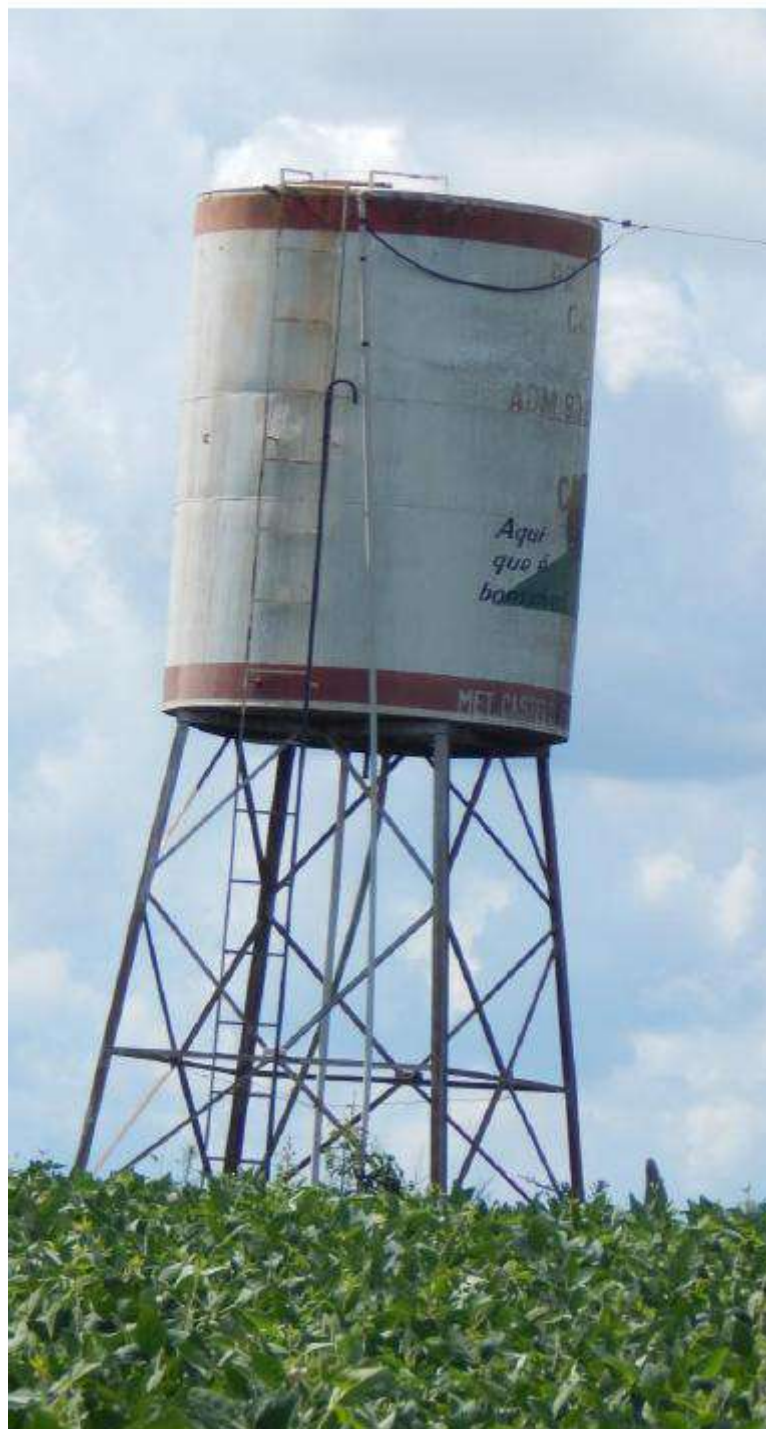
Figura 68. Reservatório de água Conceição Sul.
