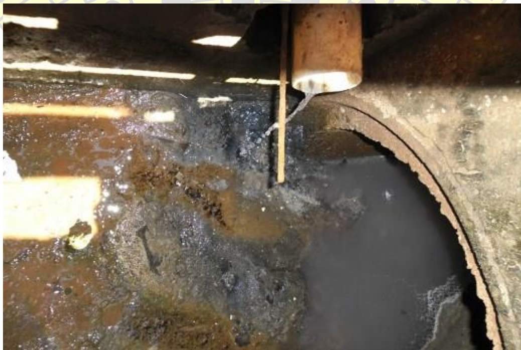
Imagem 31: Boca de Lobo – Esgotamento Irregular.
