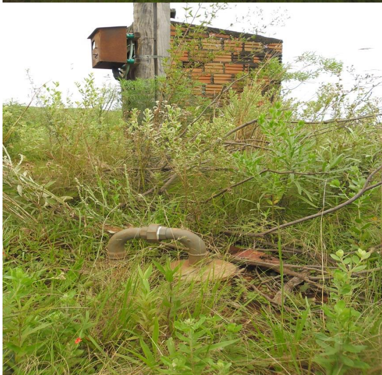
Imagem 28: Poço comunitário Rincão das Chácaras.
