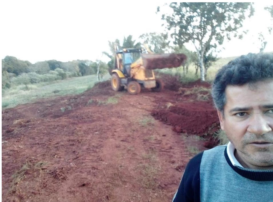
Foto 5 aterramento de rede Sitio Langner
