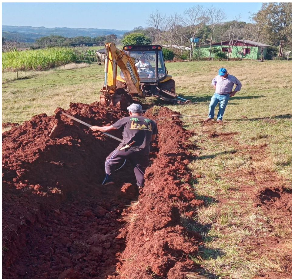
Foto 6 Aterramento de rede em Linha Fonseca
