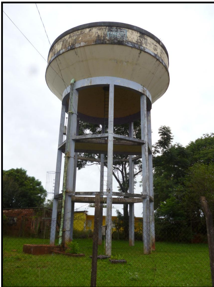
Figura 14: Reservatório do SAA de Redentora.
